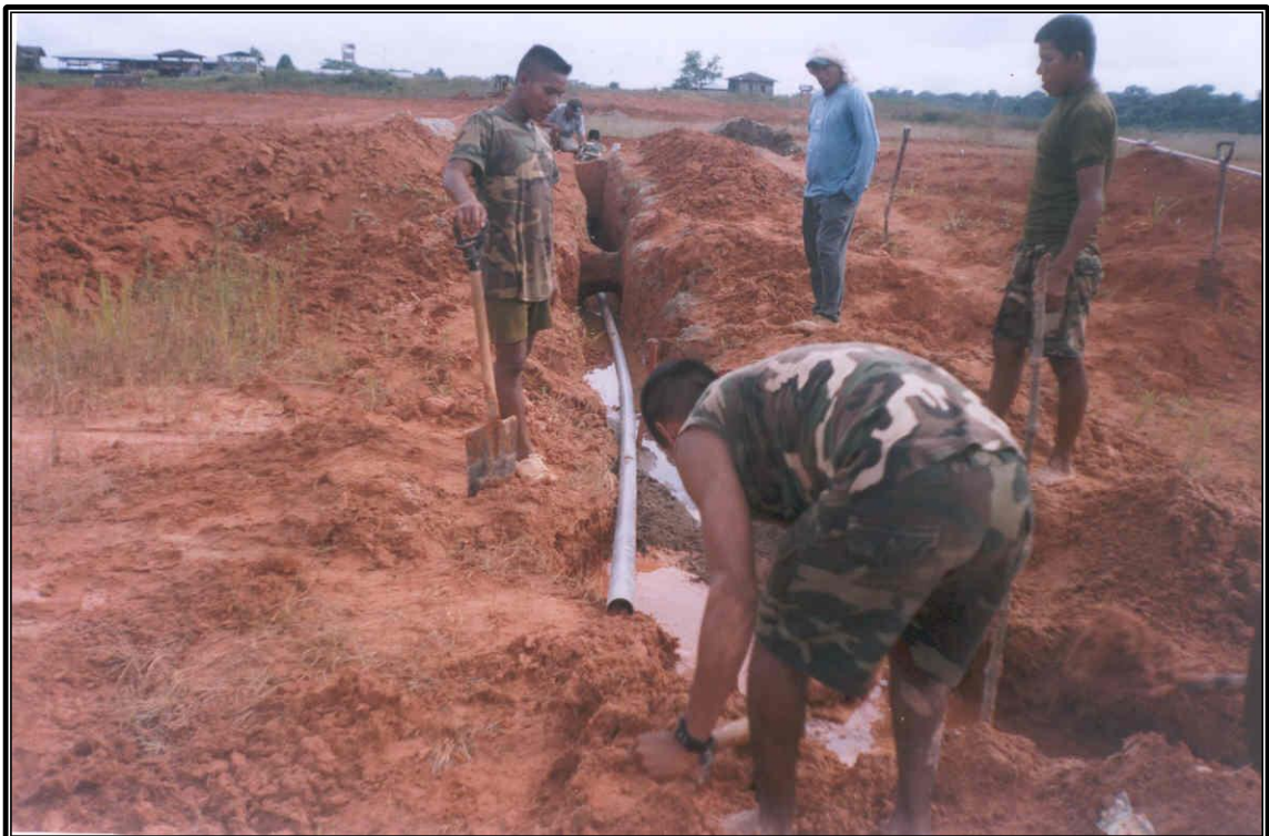
COLOCACIÓN DEL DUCTO DE DRENAJE PARA LA EVACUACIÓN DE LAS AGUAS PLUVIALES
