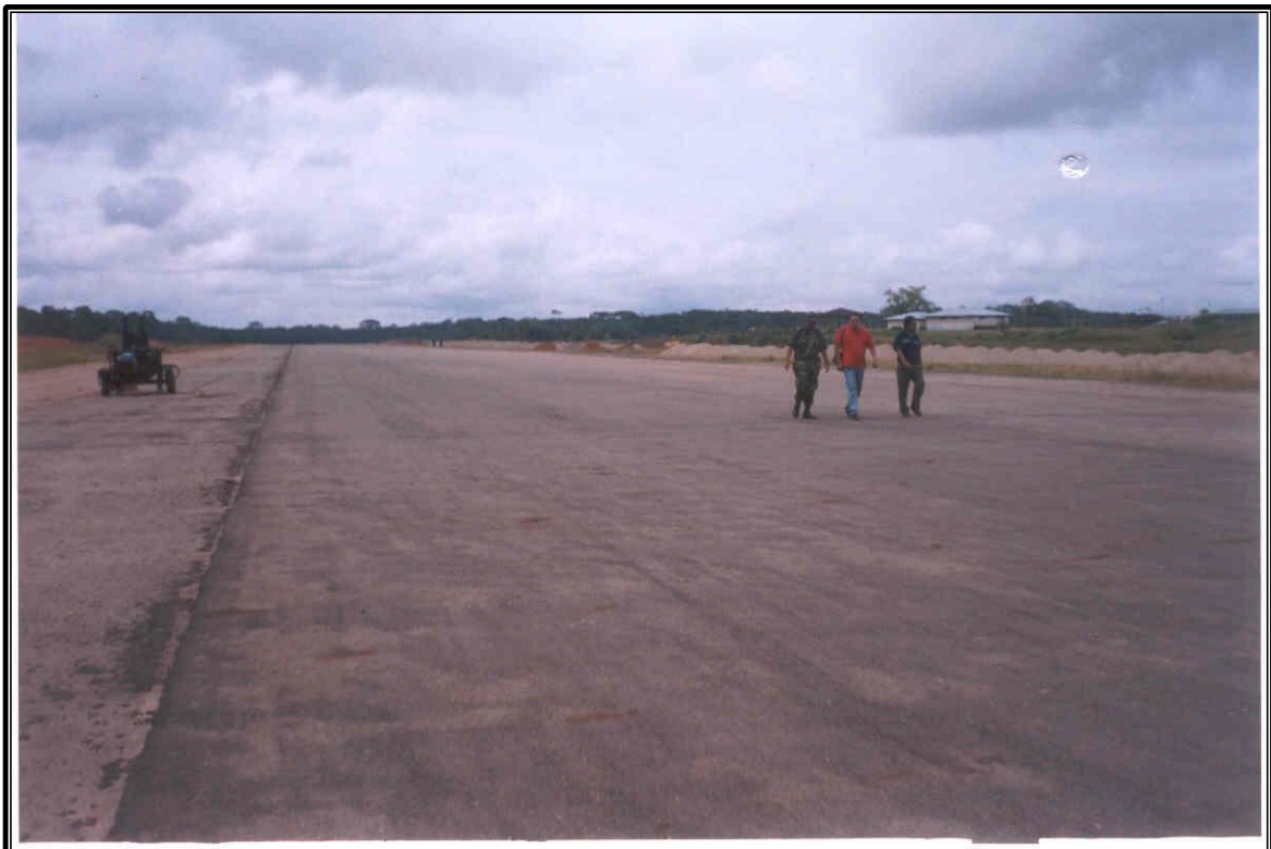
RECORRIDO DE LA PISTA DONDE SE APRECIA LA ARENA ACUMULADA
