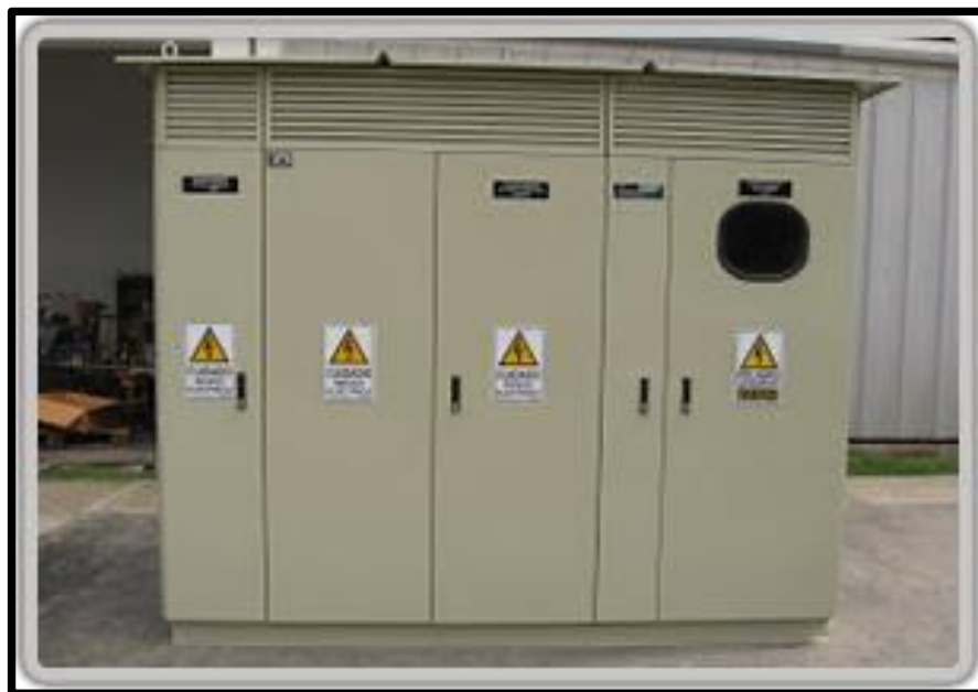
Estación eléctrica de la Base Contrasubversiva
