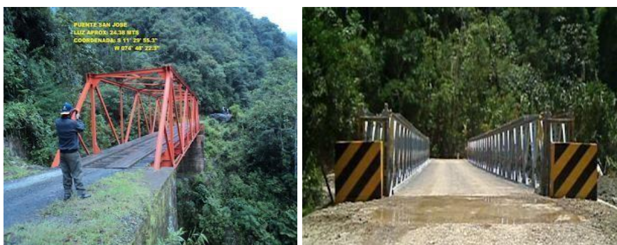
Figura 18. Puente San José (antes y después). Puente nuevo con una capacidad de 48 TN.
